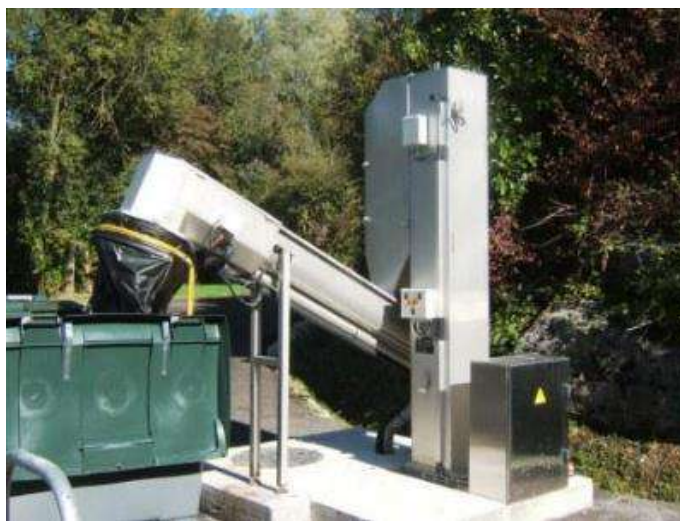
Dégrilleur automatique avec ensacheur
